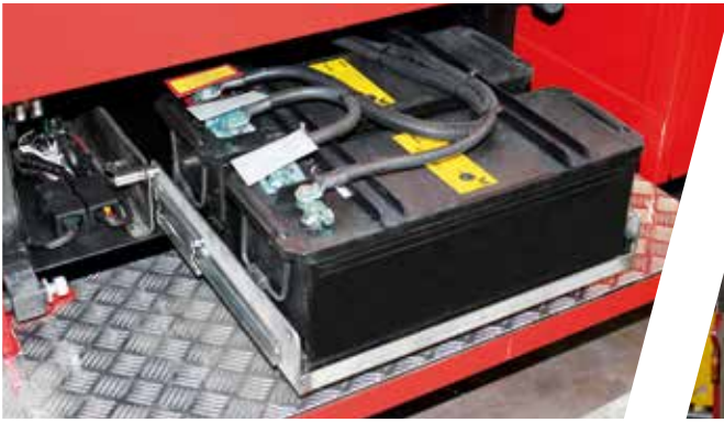
Batterien auf Edelstahlauszug hinter Trittstufen Batteries behind the fold-out step on a stainless steel extension
