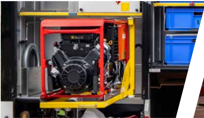
Drehwand mit Stromerzeuger in G6 Swing-out wall with generator in storage room G6
