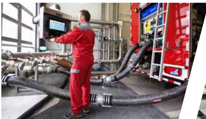
Pumpenprüfstand Pump test stand
