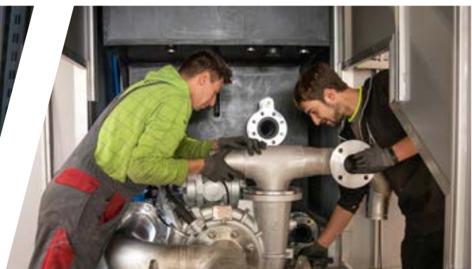
gesamte Verrohrung in Edelstahl-Schweißkonstruktion entire pipework in welded stainless steel design
