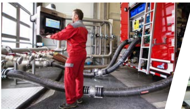
Pumpenprüfstand Pump test stand
