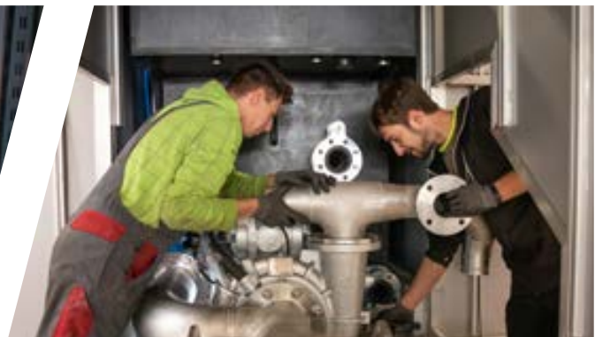
gesamte Verrohrung in Edelstahlausführung entire pipework in stainless steel
