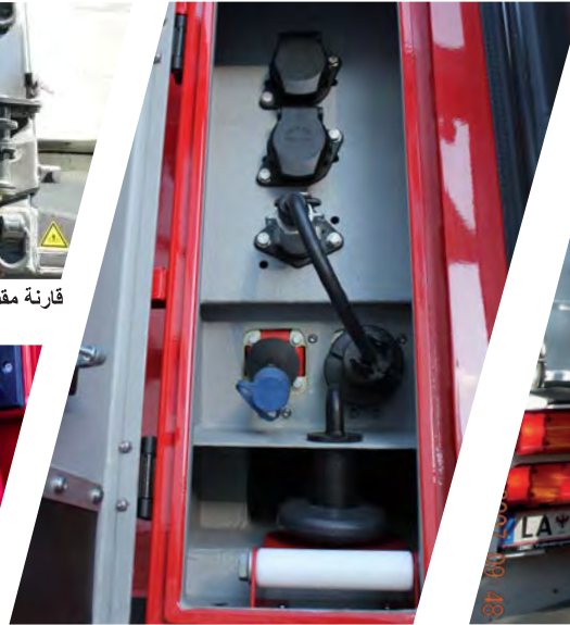
وصلات إمداد كهربائية
